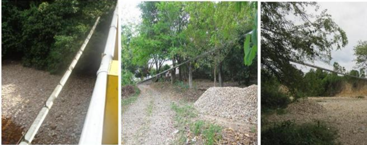
Fotografías 5 Acueducto Y Alcantarillado De Erosion De La Quebrada La Pava
