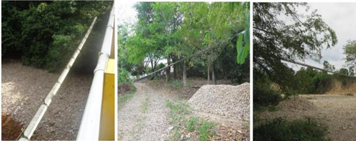
Fotografías 5 Acueducto Y Alcantarillado De Erosion De La Quebrada La Pava
